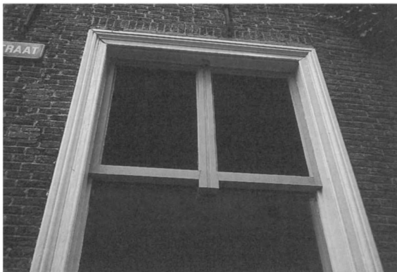
2 's-Hertogenbosch, Markt 15 hoek Kolperstraat 2. Doorlopende middenstijl van bovenraam.
